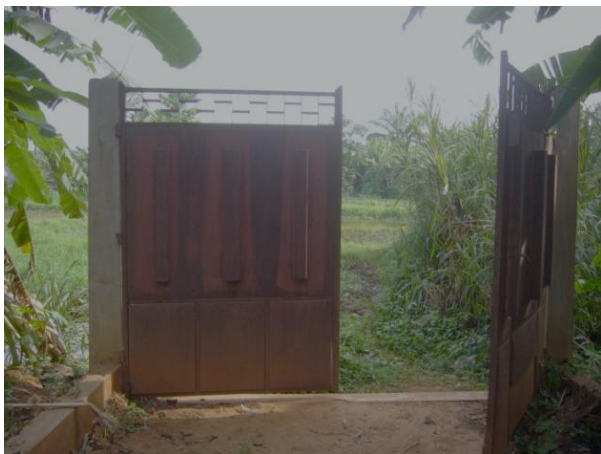
Donoukin : Reste d' une maison emportée.
