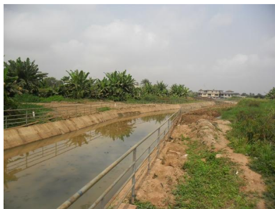
Le bras du collecteur G traversant le Donoukin draine les eaux pluviales et usées de la Ville.
